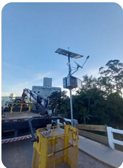
Estação de monitoramento em instalação no município de Presidente Getúlio Foto: ASCOM/SDC
